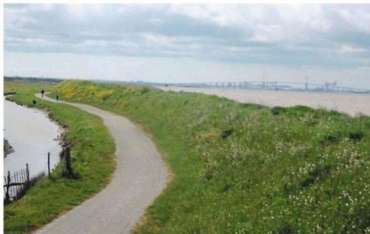
La digue en bord de Loire protège la piste cyclable de La Loire à vélo, et derrière l'étié, les habitations qui bordent le fleuve.
